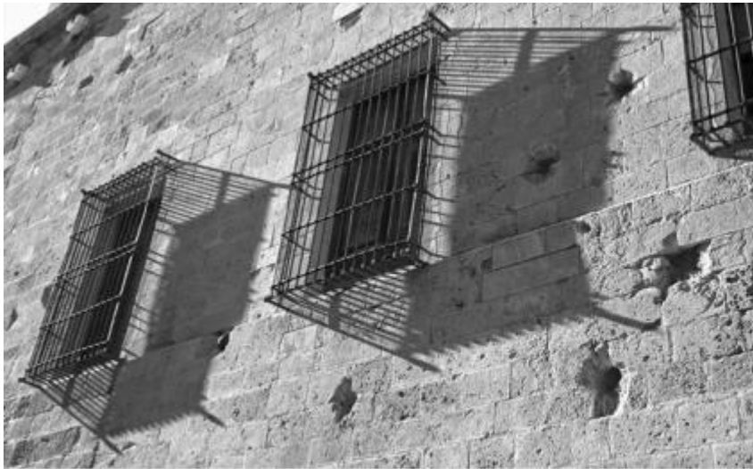
IMPACTOS DE ARTILLERÍA EN LOS MUROS DE LA IGLESIA DE SANTA MARÍA. (Fotografía de Antonio Soler)
